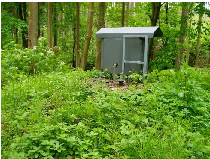
Obr.3. Zemní armaturní šachta nad vrtem PH-2.
